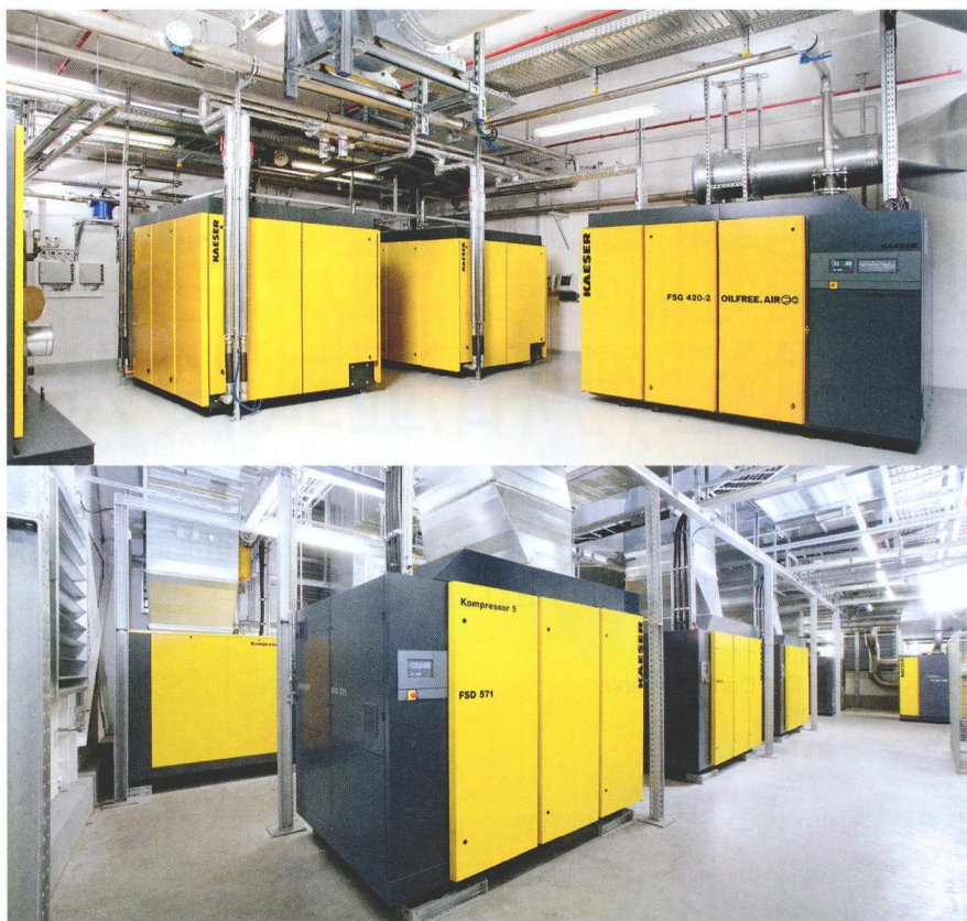
图2从外观上来看, 干式运行的空压机站与喷油冷却的空压机站没有区别
