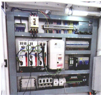
图 电气控制柜
