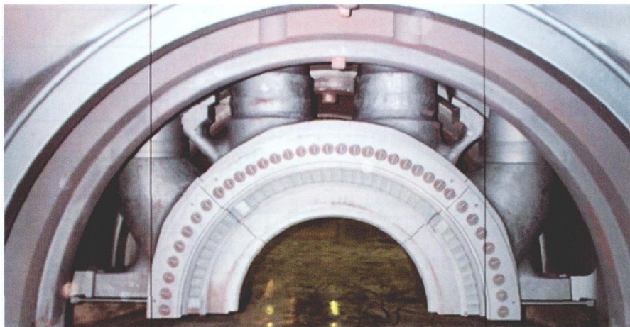
图 2 升级一些汽机部件，诸如本图所示的高压汽机控制的部分，也是一种改进热耗率的方法
