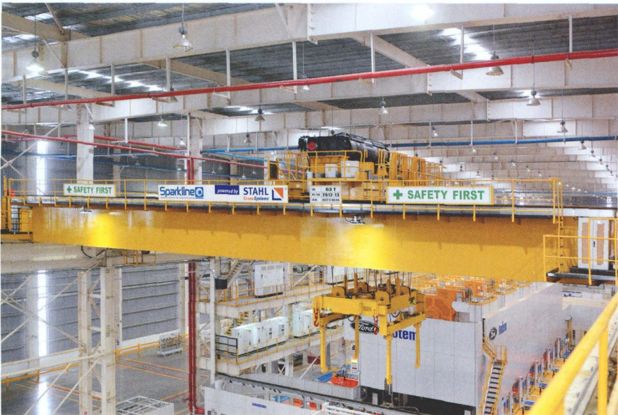
图2 这套起重机系统的核心是 STAHL CraneSystems 的 SHW 8 卷扬机。在 Künzelsau 的生产过程中，它们已经准备好实现非常快的起升速度与安装模具夹具
