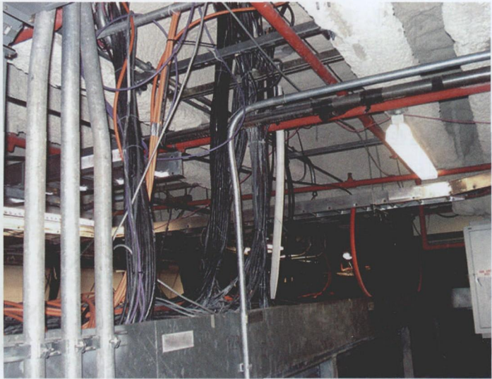
图4 这种电缆廊道采用洒水灭火装置进行保护（天花板处的红色管道）
