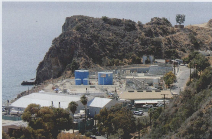
柴油发电机、丙烷供能 Capstone 微型涡轮机和钠硫蓄电池的组合为加利福尼亚的 Santa Catalina 岛供应着电力。这座电厂还通过海水淡化供应着岛上的供水需求
