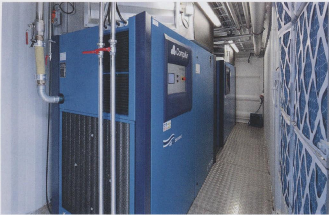
图4 三台转速可调、功率为 75 kW 的空气压缩机为 GKD 工厂提供所需压缩空气
