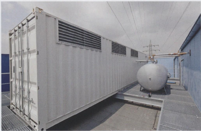
图5 压缩空气储罐也被安装在车间屋顶
