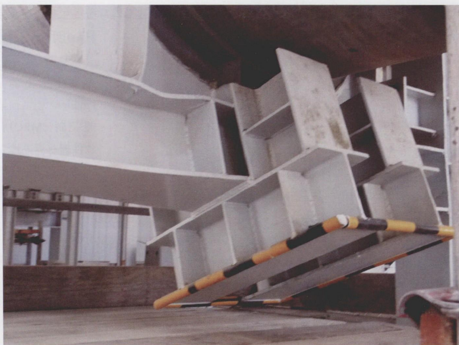
图 4 水锤对大口径高压蒸汽管道支架的破坏是不可忽视的
