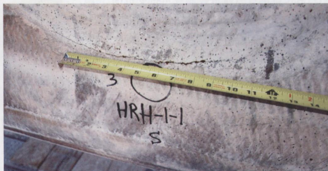
图3 91 级高温再热斜接支管台开裂会导致疲劳和IV 型徐变损伤
