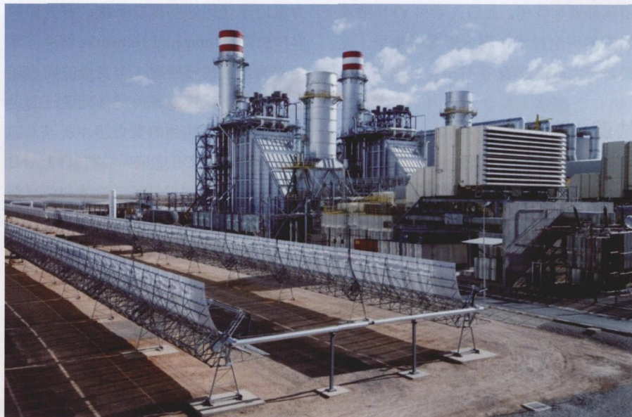
Ain Beni Mathar 集成太阳能联合循环电厂位于摩洛哥东部，生产能力达 470MW，其中 20MW 来自集中式太阳能系统
