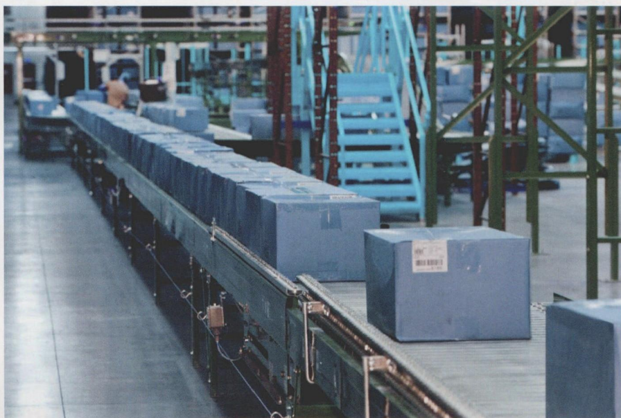
图 2 穿梭车系统大大提升了配送中心的仓储效率
