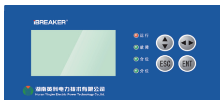
图4 柱上开关控制单元显示模块
