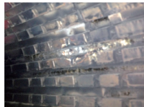
图8 6#给水泵定子槽楔脱落情况2
