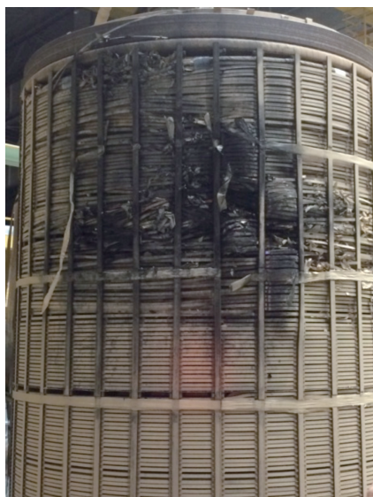
图4 1号主变压器B相吊罩检查图
