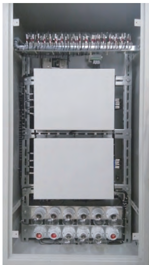
图4 安装有智能选相开关的电缆分接箱
