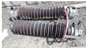
图3 故障避雷器外观检查
