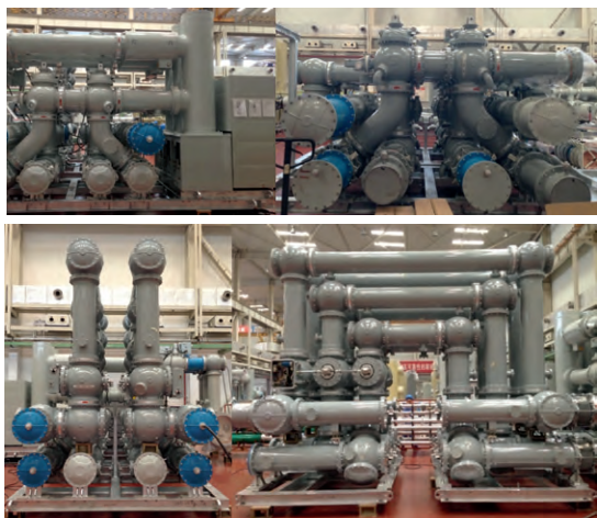
图8 三相分箱母线的部分工程应用
