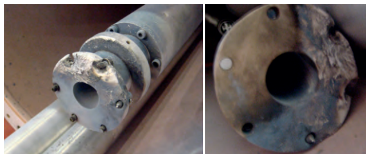
图1 试验失败后导体损坏
