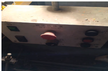
图2 轿顶检修盒外观
