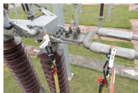
图7 新型回路电阻仪测试线接线钳使用范例
