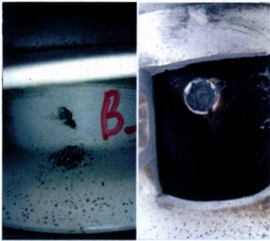
图5 缺陷避雷器解体情况
