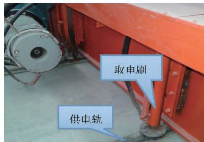
图 3 移车台受电刷的取电过程
