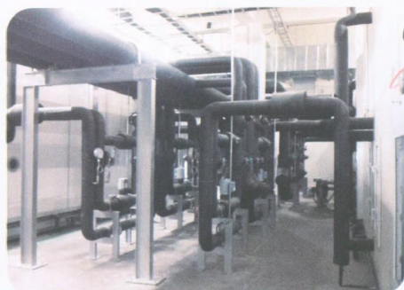
MAU 空调箱系统实景图
