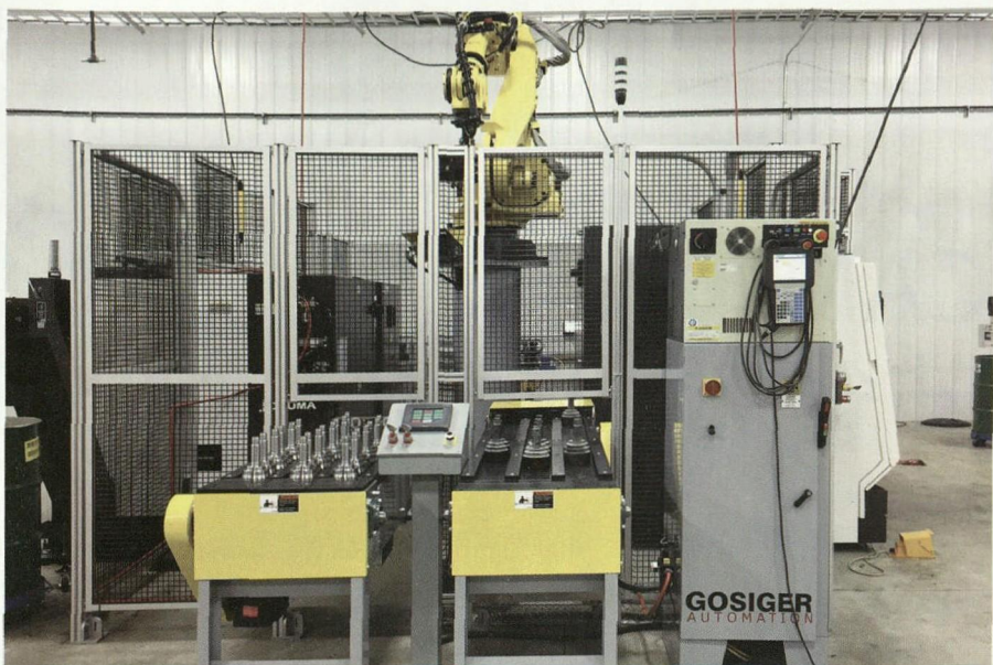
图 3 操作人员手动连续将 40 个粗糙工件按照随机径向取向放置在钢制平顶来料传送机上，机器人抬起零件，使用摄像头确定工件朝向，然后将零件装入第一个车床
