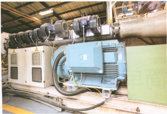
图 4 200kW IE4 的 SynRM 电机整齐地安装到挤出机用直流电机腾出的空间
