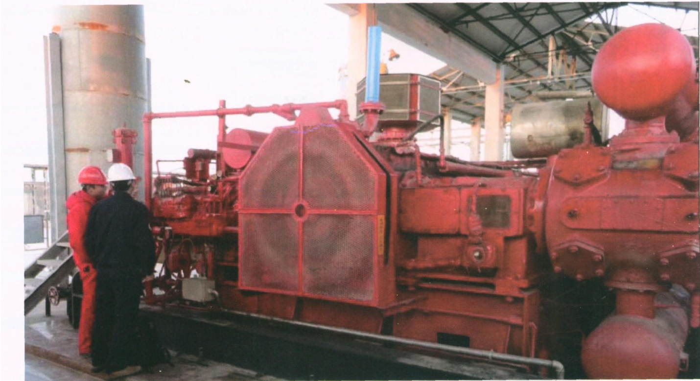
图 1 吐哈油田温米采油厂轻烃站内的天然气压缩机
