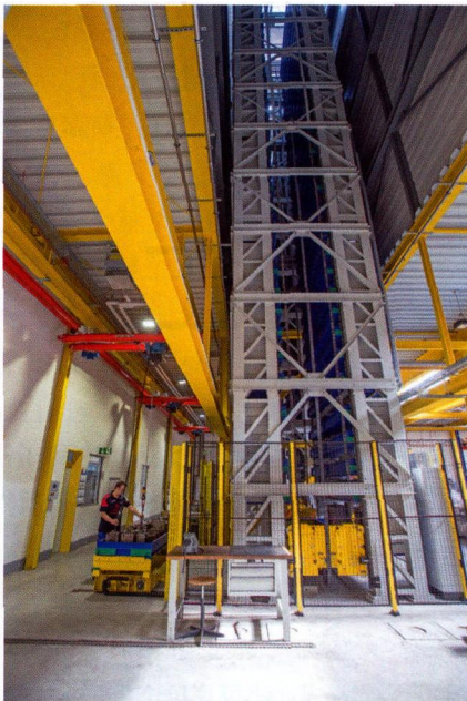
图 2 Paul Henke 有限公司的塔式库房的三个 Intertex 库房塔的底面积仅为 55m 2 ，能够为 3000 件重的制作压铸件的工件提供存放位置
