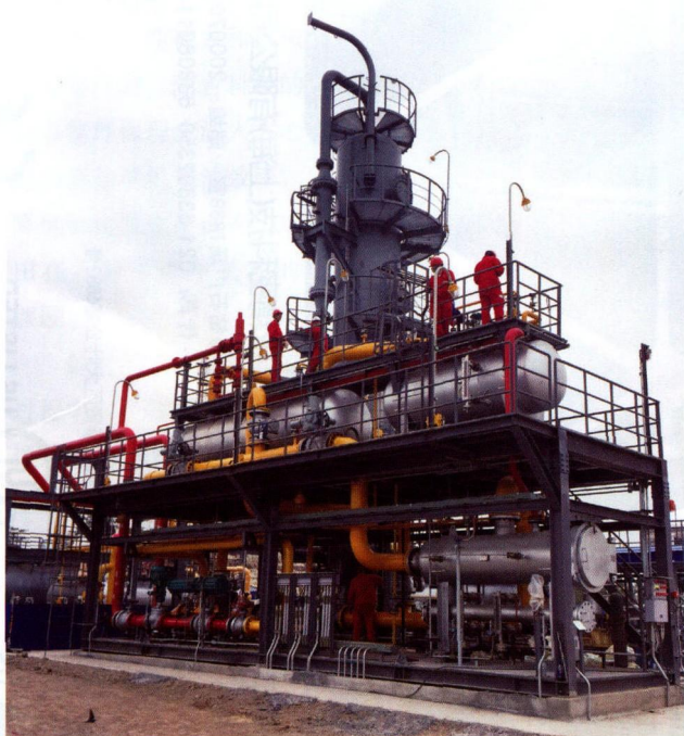
图 1 威远气矿现场站
