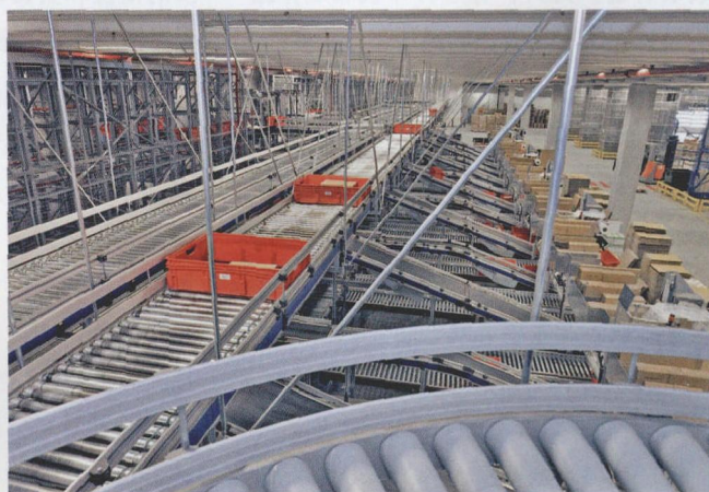
图 2 Winkler 公司的库房设施和物流是该公司提高生产效益的关键环节
