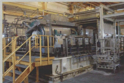
挪威石油公司的压缩机设备现场
