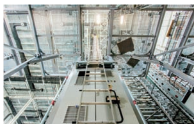
西门子变频器堆取立体仓库
