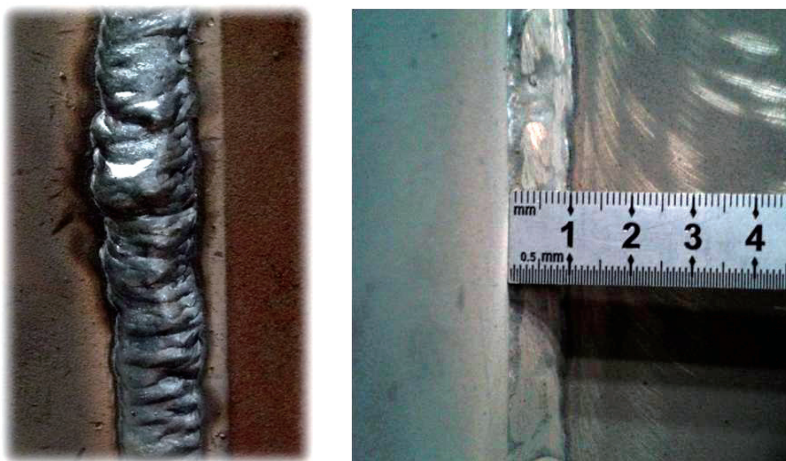
图1 实际施焊宽窄超标焊缝及打磨后焊缝
