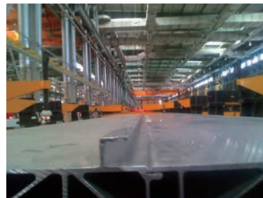
图5 焊缝状态示例
