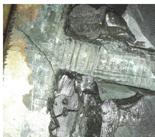
图4 管板边缘处的裂纹
