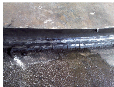
图1 环缝横向裂纹
