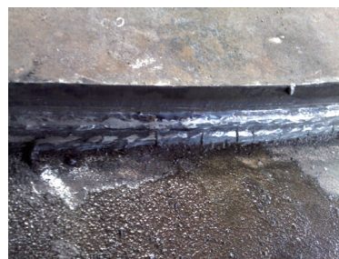
图1 环缝横向裂纹
