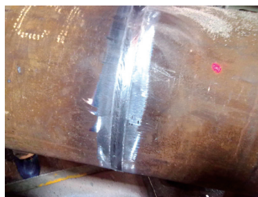
图3 焊缝外观形貌
