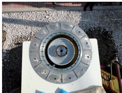
图4 有载开关托板实物图
