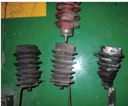
图2 母线室三相隔离开关支柱瓷瓶炸裂
