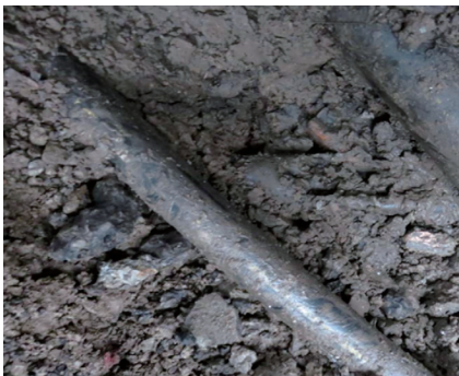
图4 地埋电缆损坏
