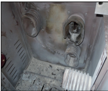
图1 开关柜有明显放电痕迹
