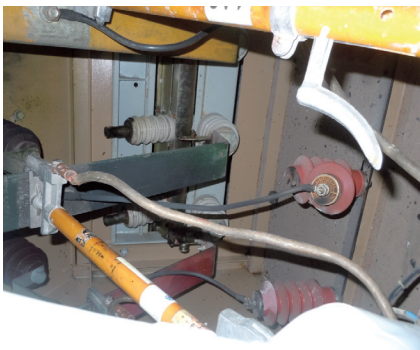
图3 部分高压避雷器炸裂
