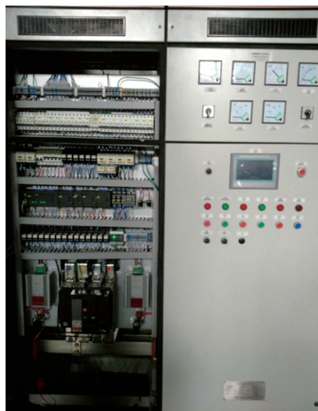
图4 柴油发电机ATS双电源转换柜
