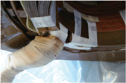
图3 B相低压侧绕组出线发黑开裂
