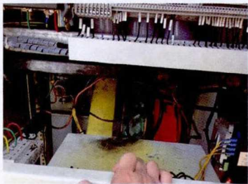
图3 事故箱式变压器柜内损坏情况照片
