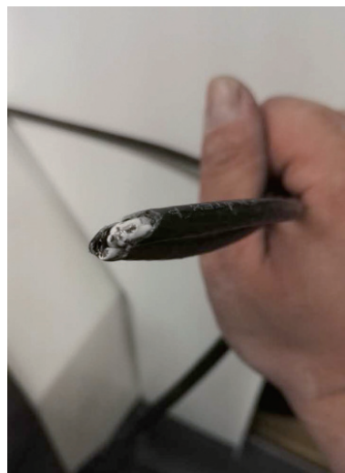
图3 多芯电缆破损
