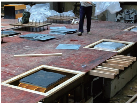
图6 隔振器四周支撑钢框架
