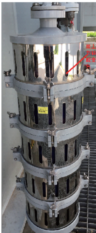
图1 特高压变压器旧式呼吸器
