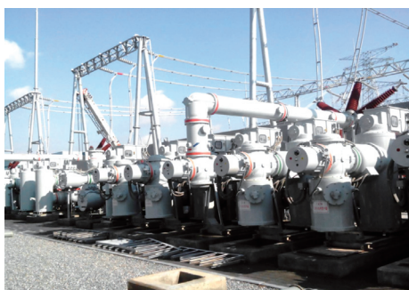
图6 145 kV GIS在三星城电站的运行
