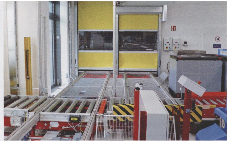
图 5 高货架库的大门可快速开启和关闭，既能起到空气流通闸门的作用，又能阻止未经许可者进入库房
