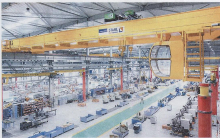
先进的起重技术：重庆起重机厂的起重机达到欧洲的品质要求，搭配了 STAHL CraneSystems 的起重技术
