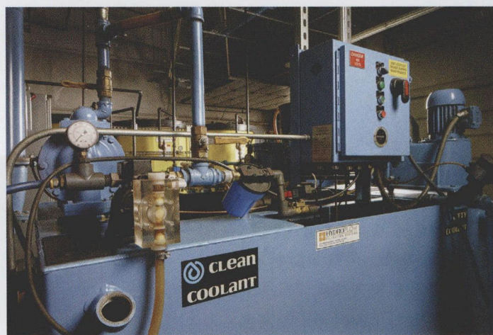
图 4 将冷却液比例器和控制器安装在 CRS 清洁箱上，其向回收的冷却液中添加新的稀薄补充冷却液。比例器泵后面的清洁冷却液分配泵通过架空管道，将回收冷却液泵送到工厂的机床上进行清洁处理
