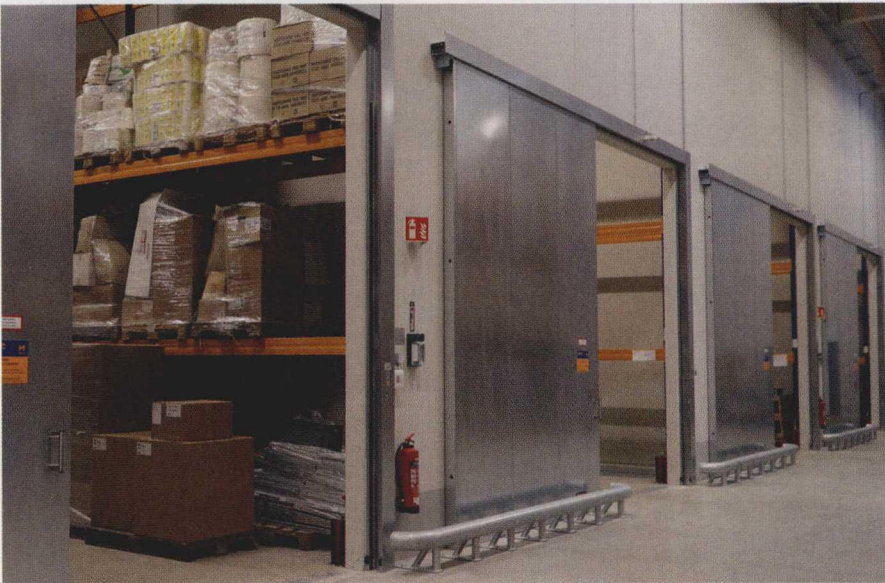
图 1 四座危险品仓库都用防火门密闭的隔离起来了。每一间危险品仓库都是一个独立的防护单元，因此都要有自己的自动关闭的防火 / 阻烟密闭门
