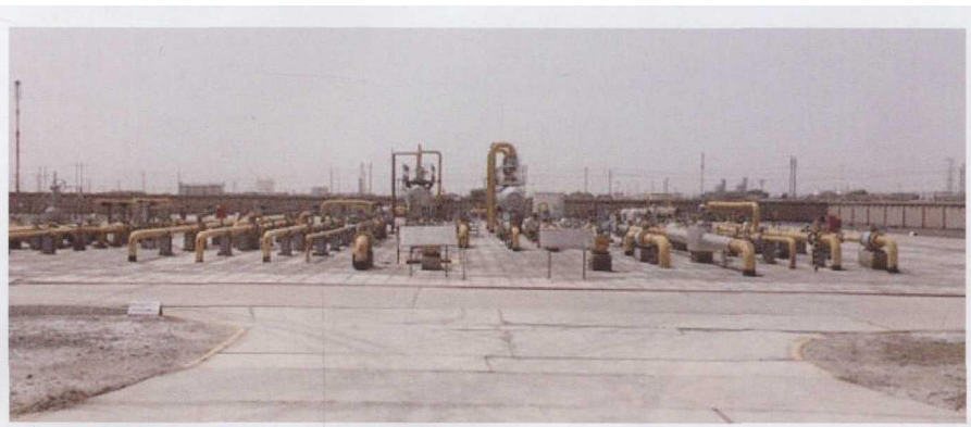
塔里木的油气储运站
